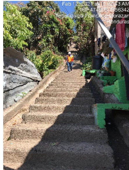
Ilustración 10. Sistema de gradas con pendiente pronunciada y sin barandales.
