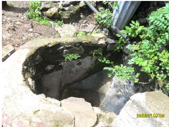
Ilustracion 3. Zona de descarga de aguas pluviales insuficiente para el caudal generado en periodos intensos de lluvia.
