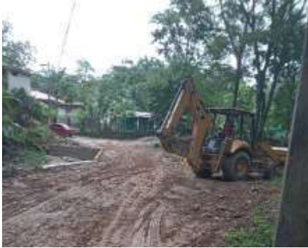
Apoyo al Depto. de Mantenimiento Vial En la reparación de embaulado de Zapadril Abajo, Sector Zapadril.
