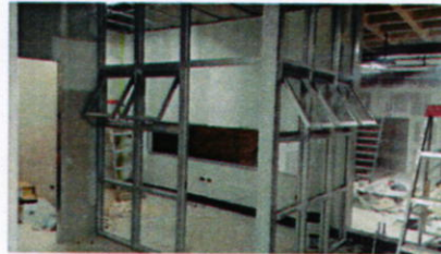
Avances de lo que sería paredes de vidrio y forros de tabla yeso.
