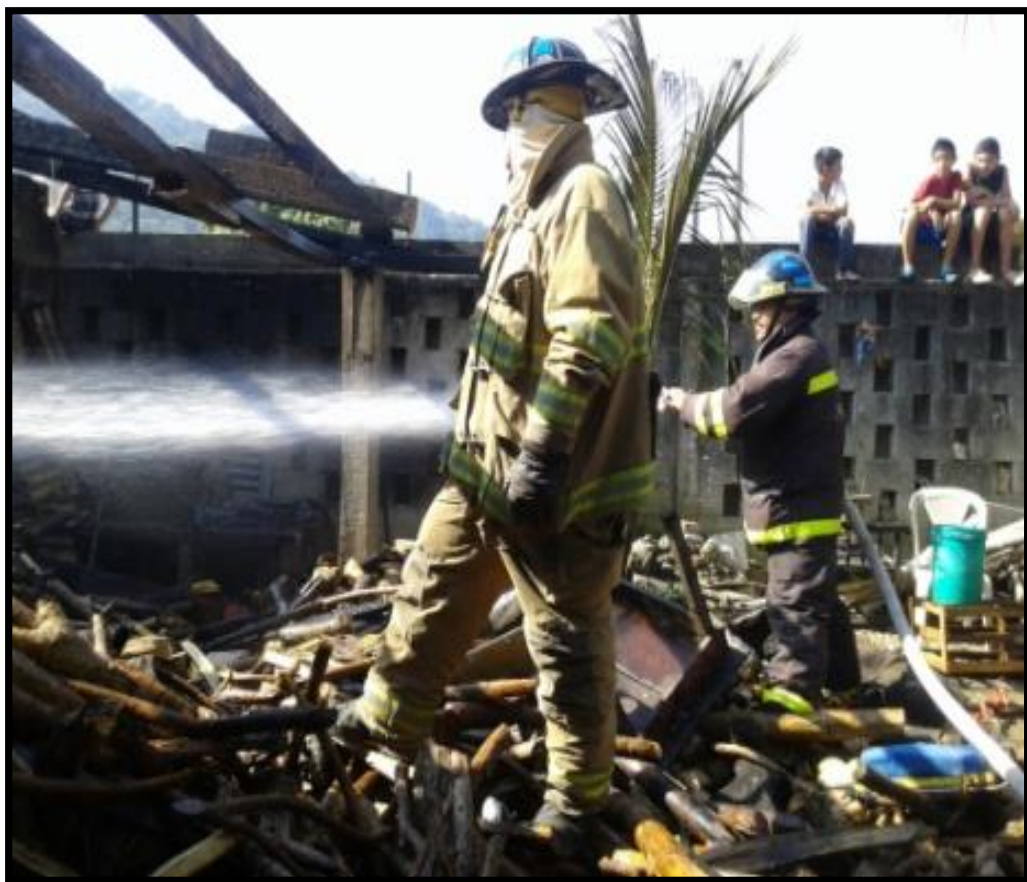
Actividad : Extincion de Incendio Estructural Lugar: Puerto Cortes, Barrio Nuevos Horizontes, Colonia 23 de Abril Fecha: 25/02/2016
