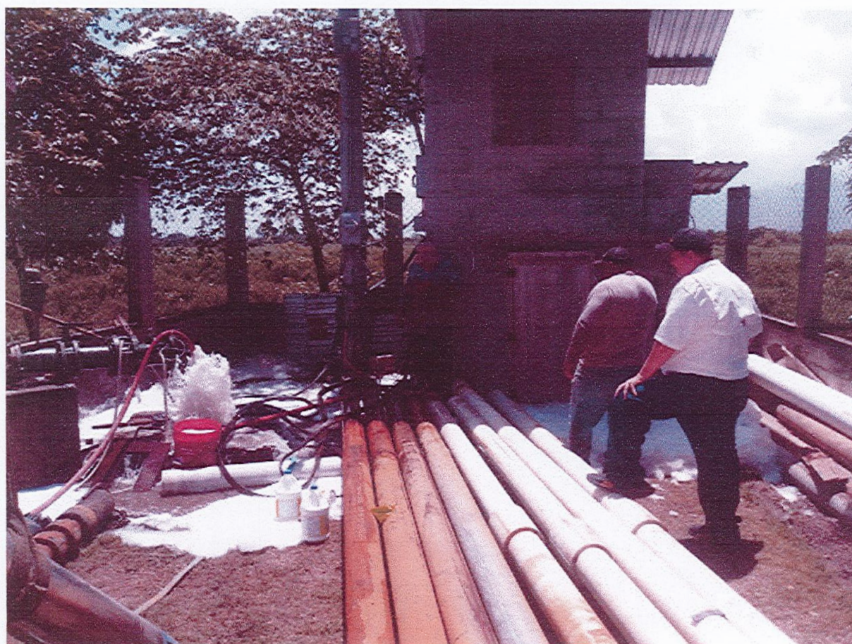
INSTALACION DE CONTROLADOR DE ARRANQUE DEL SISTEMA DE BOMBERO DEL POZO NUMERO 6.
