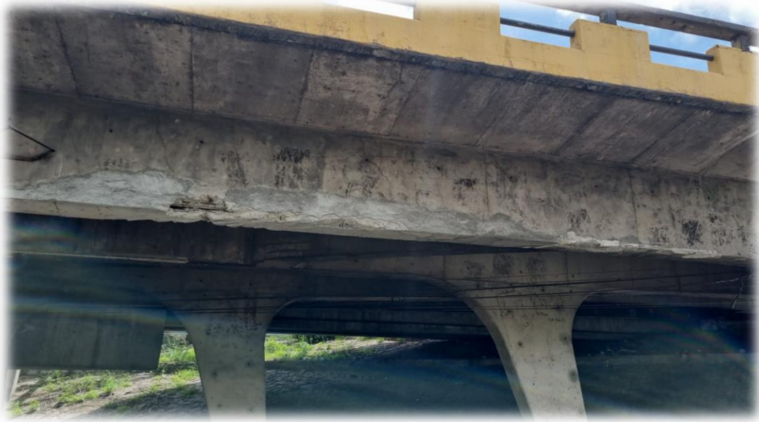
Imagen representativa de la necesidad de resanes en vigas de algunos pasos a desnivel
