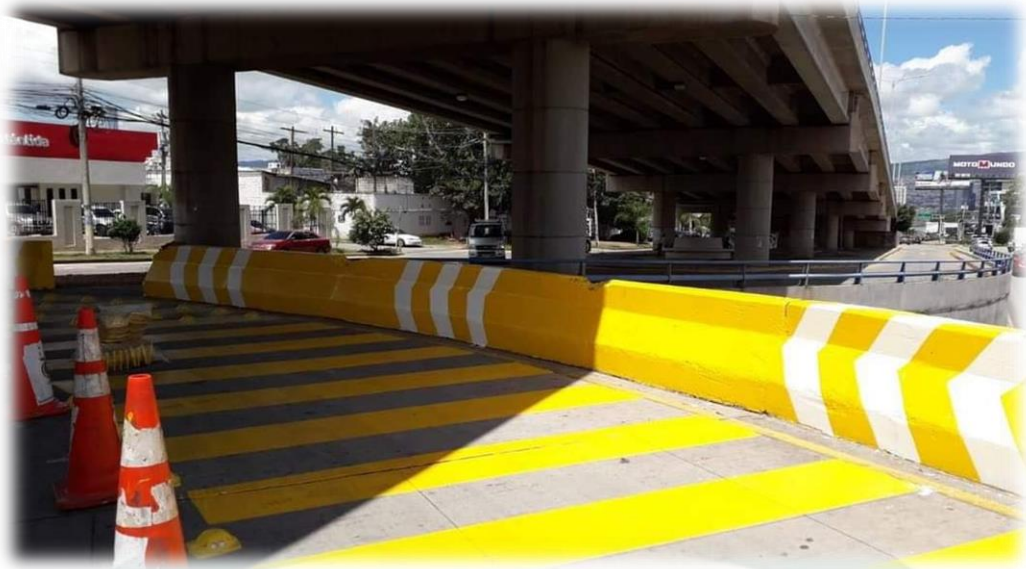
Se proporciona como referencia imagen de trabajos de pintura en barreras realizados por la AMDC
