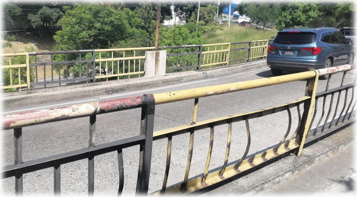
En la imagen se muestra la necesidad de reparaciones puntuales y pintura en barandales metálicos
