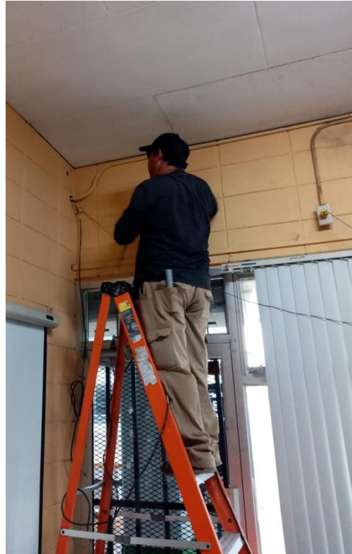
2 -Reestructuración Eléctrica en el Departamento de Investigación y Formulación de Proyectos.
