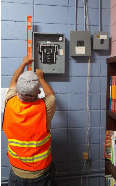
1-Reestructuración Eléctrica en el Departamento de Investigación y Formulación de Proyectos.
