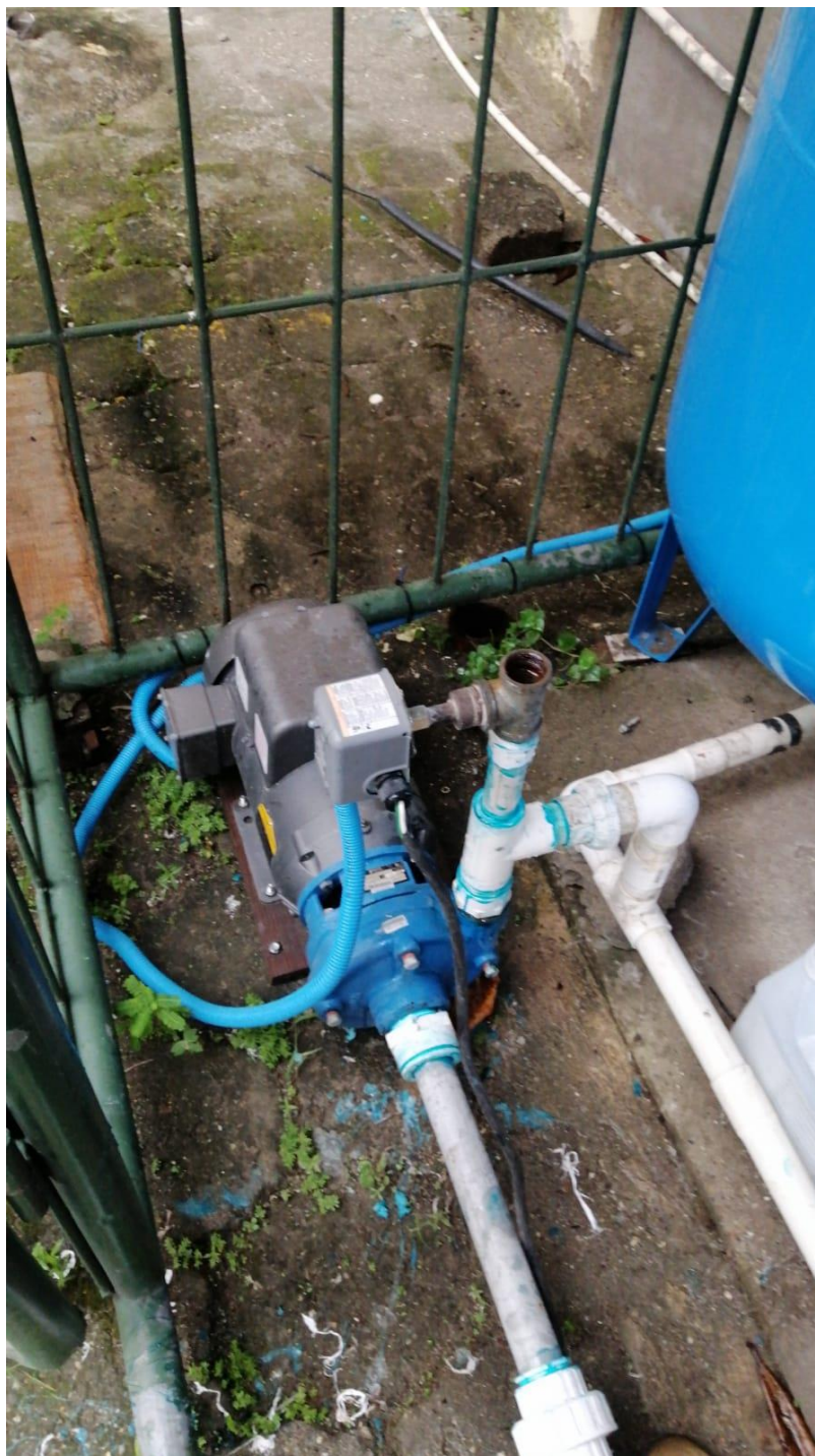
Revisión de bomba de agua que suministra agua potable a todas las oficinas del Palacio Municipal.
