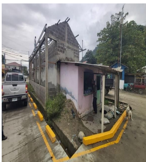
Orden de paro por construcción de techo invadiendo propiedad del vecino.
