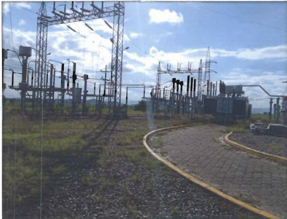
Vista Panorámica de la Subestación Santa Martha
