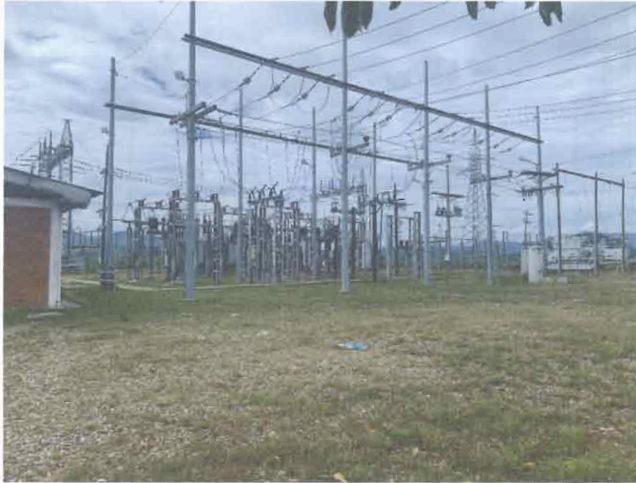
Imagen 3. Subestación Eléctrica Santa Martha
