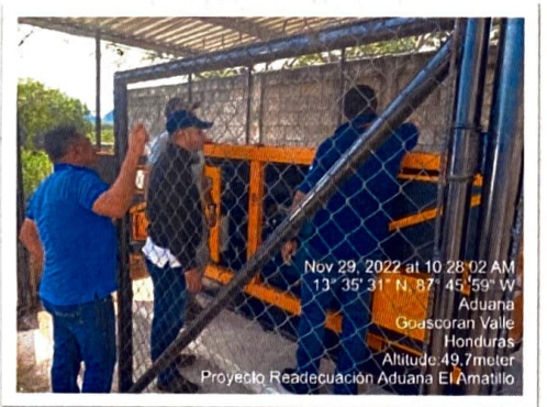
Generador eléctrico en el Andén
