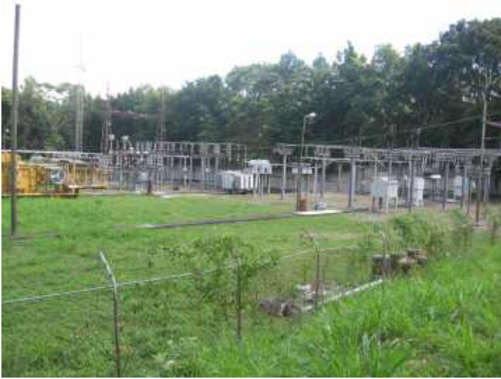
Subestación Bella Vista - ENEE
