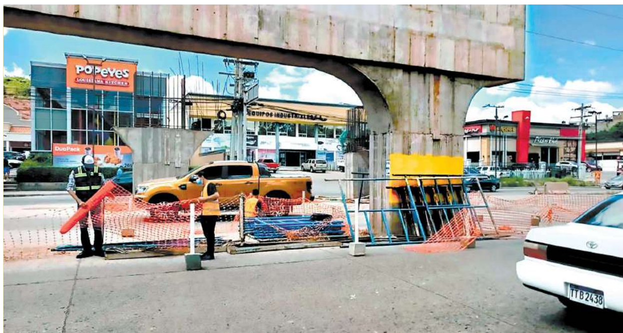
La obra se encontraba paralizada desde hace 10 meses debido al cambio de administración local.
