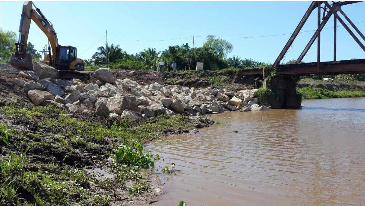
Escollera de Piedra el Toloa Creek en el municipio de Tela Atlántida
