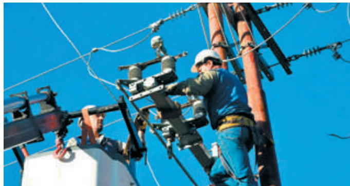
Personal de la ENEE realizando trabajos de mantenimiento y reparación de líneas en zonas urbanas y rurales del país.
