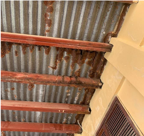
Foto 14: Techo picado por las goteras de agua en muy malas condiciones.
