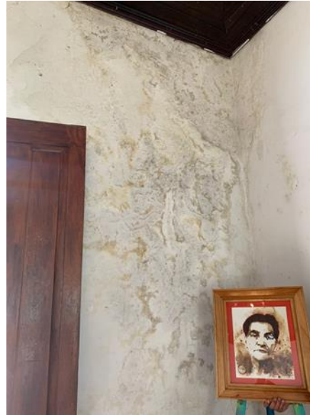
Foto 15: Paredes con bastante humedad
