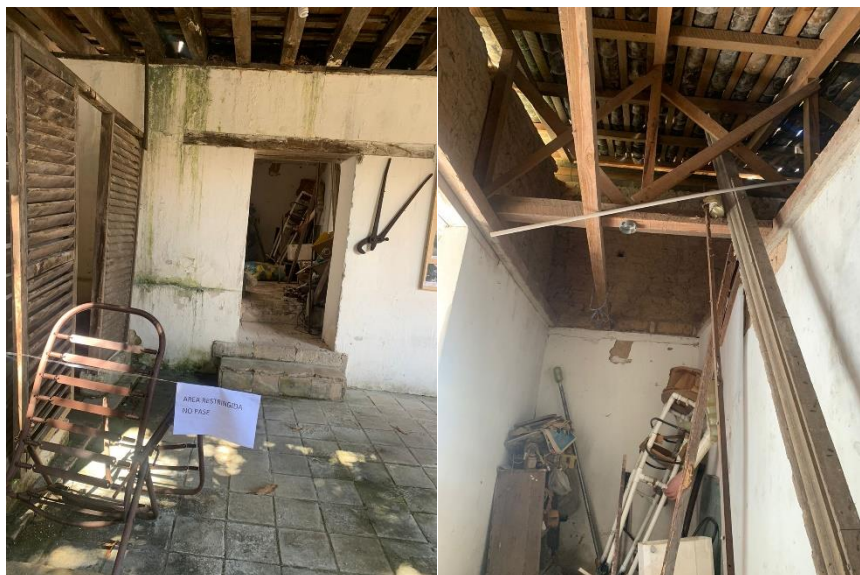
Foto 5 y 6: Aulas y techos en muy malas condiciones, no óptimas para uso.
