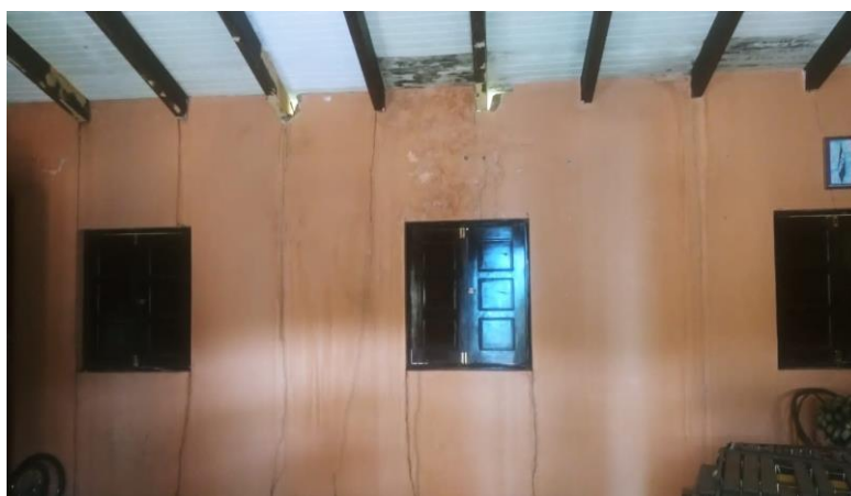
Foto 20: Techo en mal estado por goteras, debido a las fuertes
