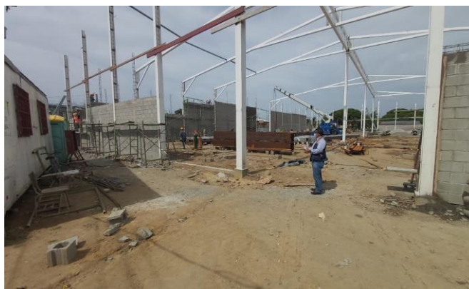
Inspección de construcción sin autorización municipal en barrio San Ramon 3 avenida, 3 y 4 calle oeste.
