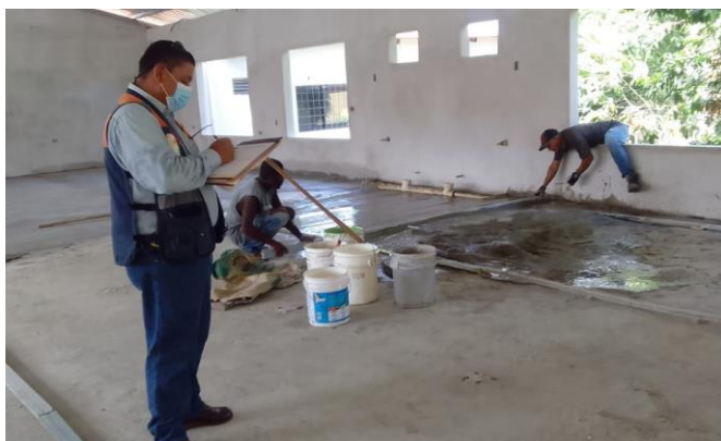
Inspección de construcción sin autorización municipal en barrio Copen, 2 y 3 avenidas, 8 calle
