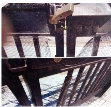
Portones frontales a reparar
