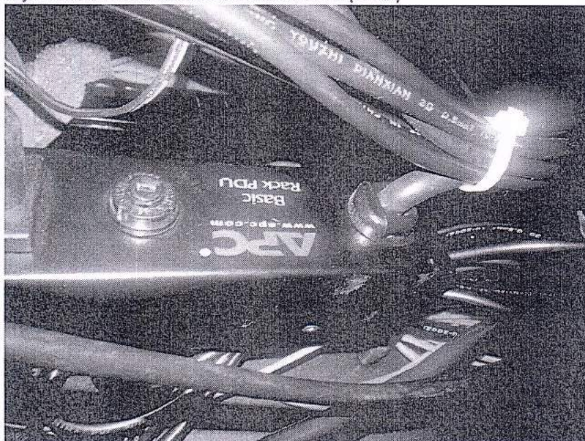
Imagen #1: Una de las PDU que presenta problemas de sobrecarga eléctrica, probablemente por un sobre voltaje recibido del sistema eléctrico externo (ENEE)
