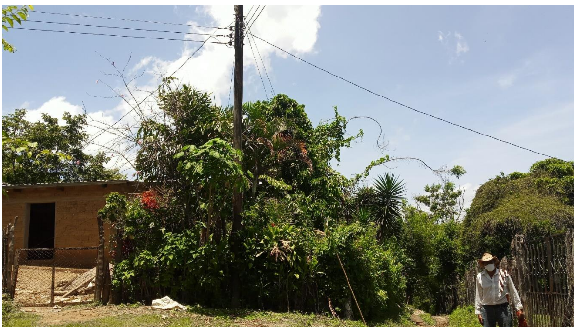
Punto 25 x=381033 y=1639267.20 Poste hueco.
