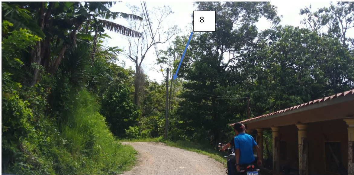
Punto 8 X=380995 y=1640047.90 poste podrido en la base.
