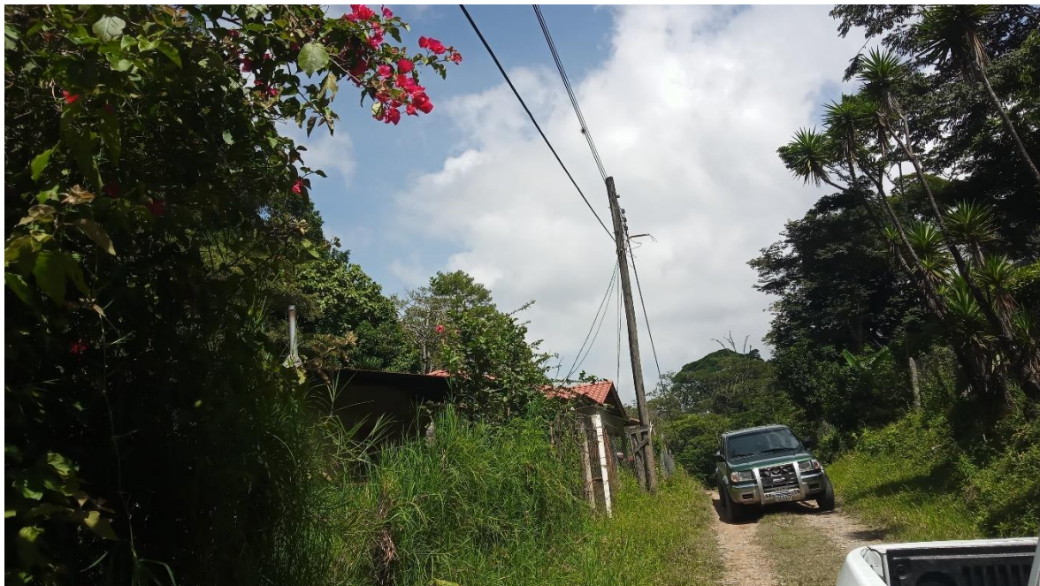
Imagen de Punto 3 x=380740.5 y=1639969.20 presenta daño en la base, la madera presenta daños por humedad, está podrido en la base.
