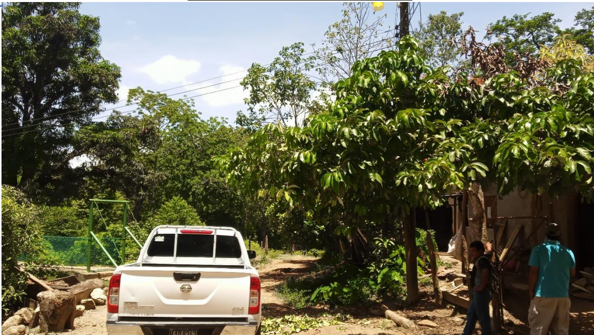
Punto 18 x=380988.80 y=1639405.70. Poste podrido en la base.
