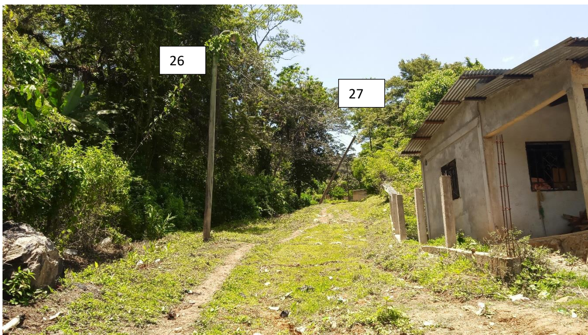
Imagen Punto 26 x=381077.8 y=1639254.70 Poste Podrido en la base. Punto 27 x=381092 y=1639233.10 Poste inclinado, este poste estaba en el suelo.
