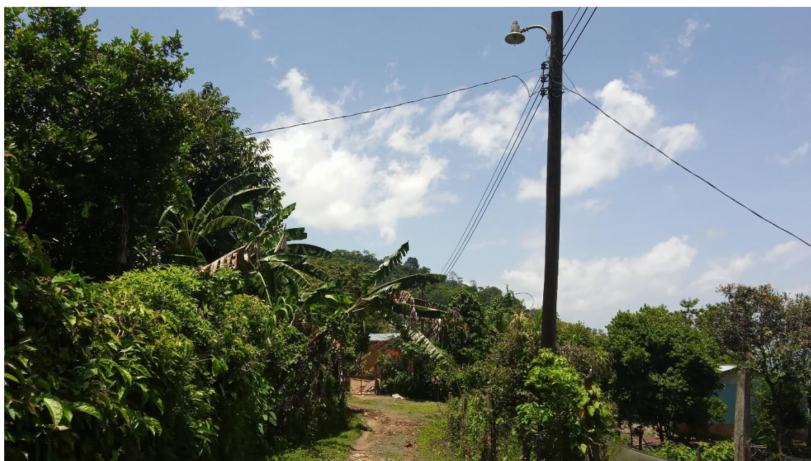
Imagen de Punto 24 x=381006.20 y=1639279.60 Poste podrido en la base
