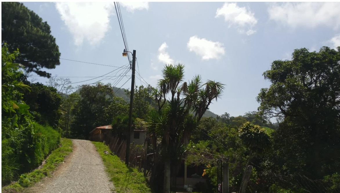
Punto 7 X=380950 y=1650023.50 poste podrido en la base.
