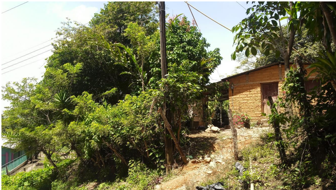
Punto 6 X=380979 y=1639823.6 Poste podrido en la base.
