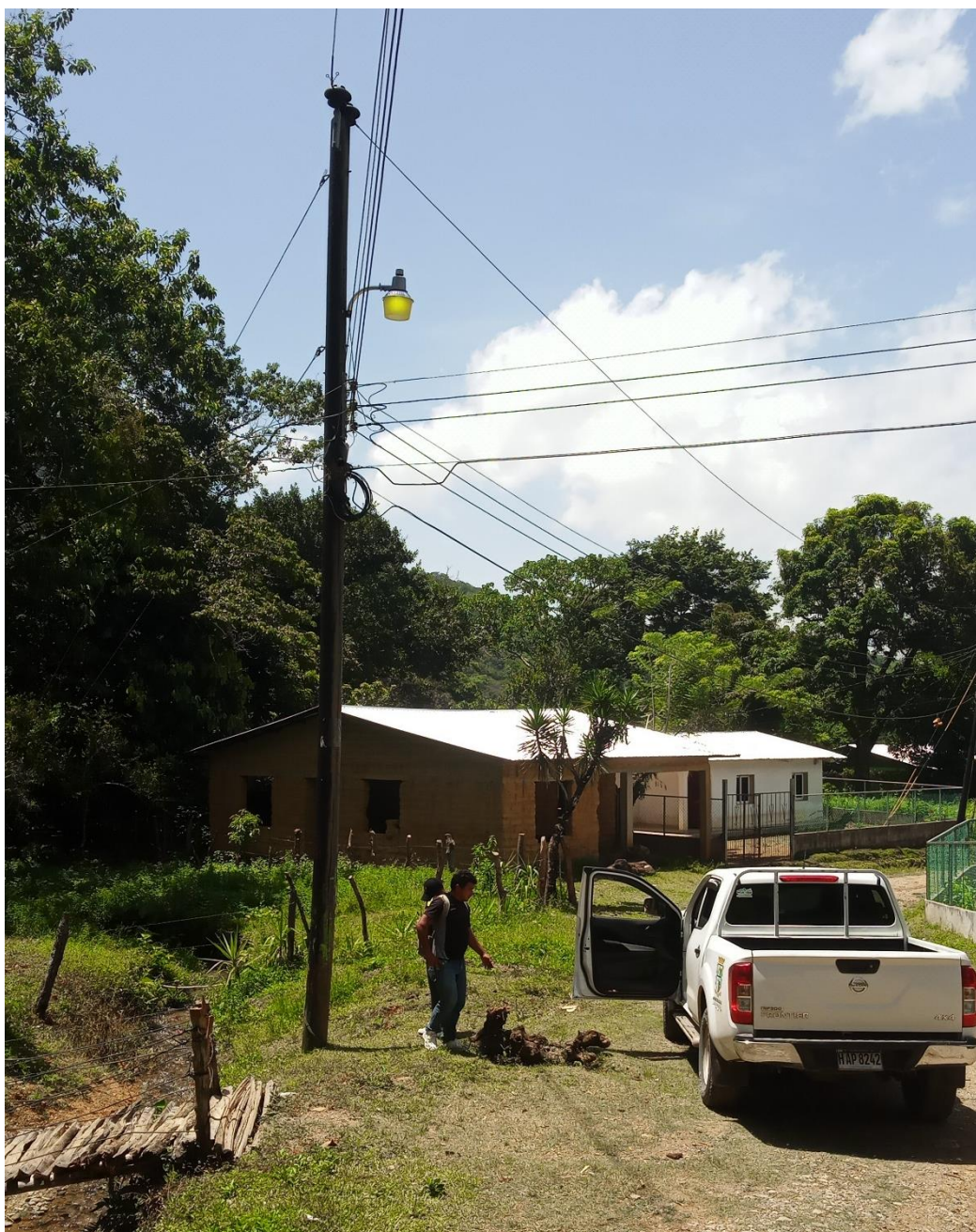
Punto 7 x=380996.8 y=1639808.20 Poste a la par de nacimiento. Presenta daño en la base por agua.
