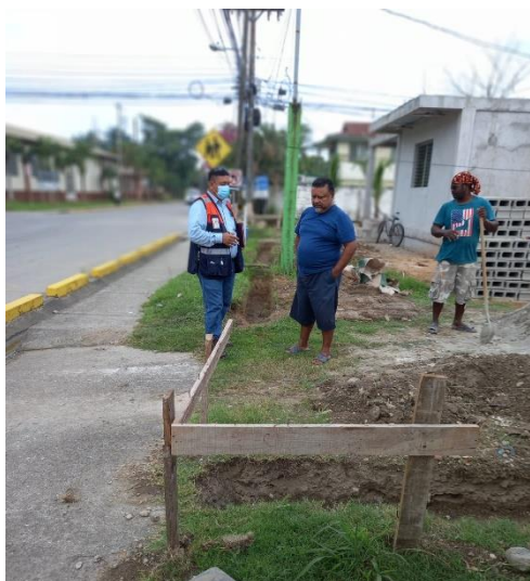
Orden de Paro por construcción de cerco sin permiso en Bo. Copen.
