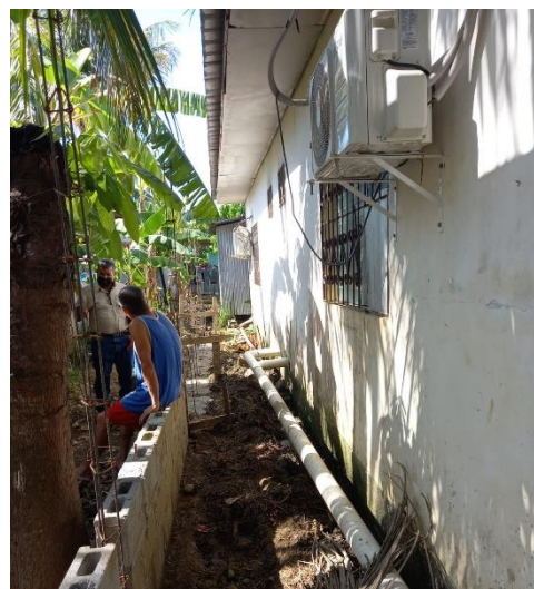
Orden de Paro por construcción de cerco sin permiso en Bo. Cienagueta.
