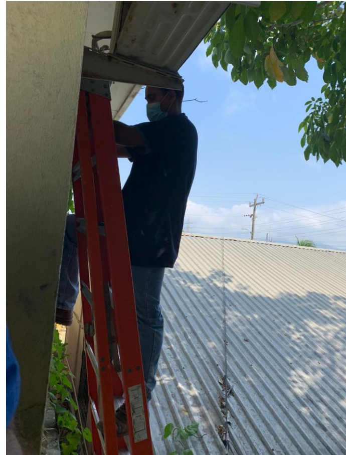
Limpieza de aire acondicionado
