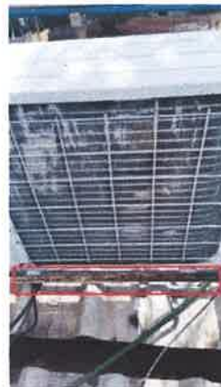
Fotografías 4. Bases para unidades condensadoras con óxido y sin protección de pintura anticorrosiva.
