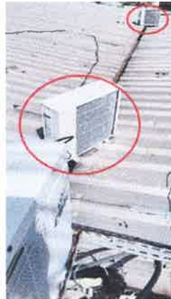
Fotografías 2. Unidades condensadoras instaladas sin uso de bases metálicas ni absorbedores de vibración de neopreno.
