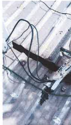
Fotografías 3. Sistema de aire acondicionado sin aislamiento térmico en las tuberías de refrigeración en azotea.
