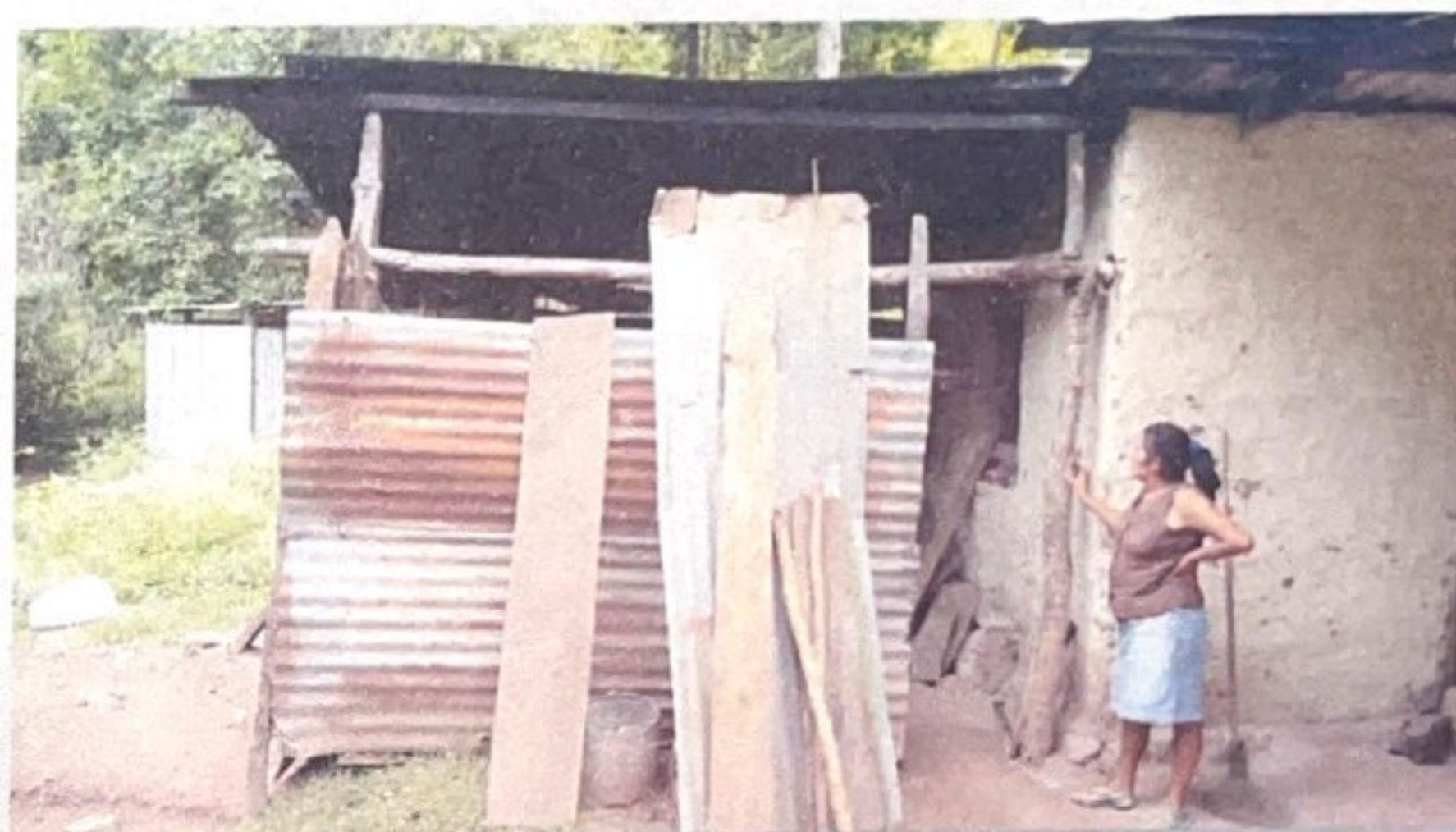
(Yorito, supervisión viviendas en mal estado, la ladera, el espino)
