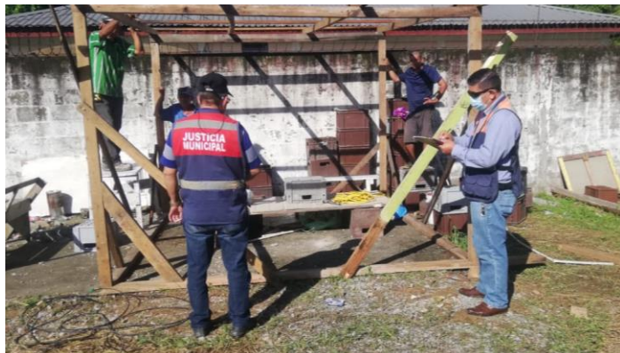
Atención de denuncia por construcción de local comercial sin el permiso correspondiente en Bo. San Ramón.
