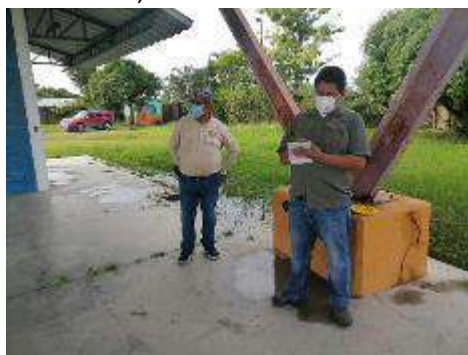
Evaluación para la reparación de la Esc. Republica de México de Bo. San Martin, Sector Península Este
