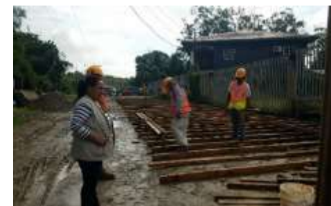
Inspección de la construcción de puente de la Comunidad de Calan, Sector Calan
