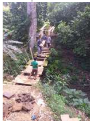
Inspección del puente peatonal de la Comunidad de Brisas de Tramade, Sector Zapadril
