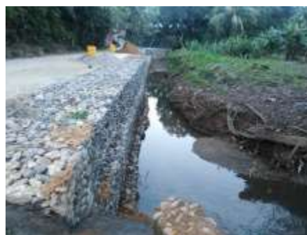
Inspección de construcción de gaviones de la Col. 5 de abril, Sector Delicias
