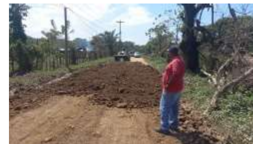
Reparación de calle de las Comunidades de Travesía y Bajamar, Sector Garífuna
