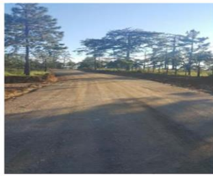
Rehabilitación de caminos rurales, Municipio de Opatoro, departamento de La Paz. EMPRENDESUR
