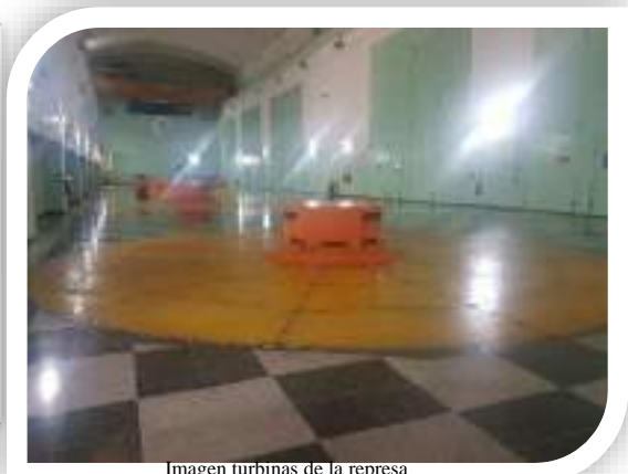
Imagen turbinas de la represa
