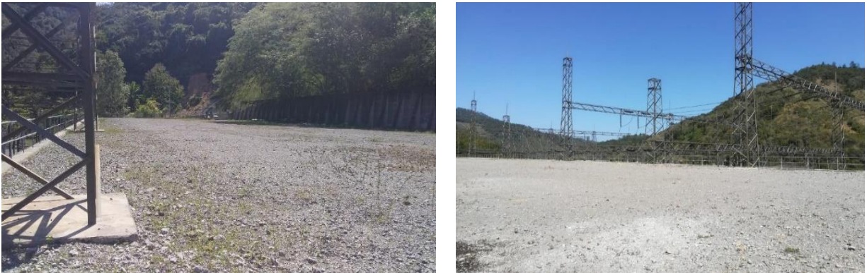
Imagen 2 - 3. Área de Ampliación Subestación El Cajón
