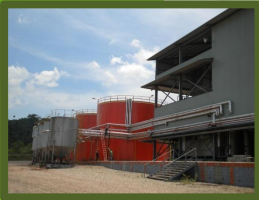
Tanques de Almacenamiento de Aceite
