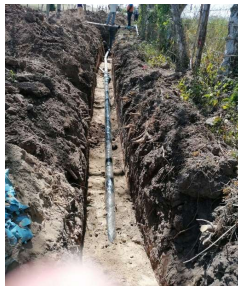
Relleno y compactacion de material en zanjas para tubería de agua del pozo a centro CURNO
