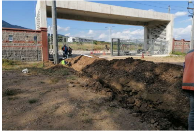
Excavacion ingreso de tubería de la línea de conducción de agua pozo.
