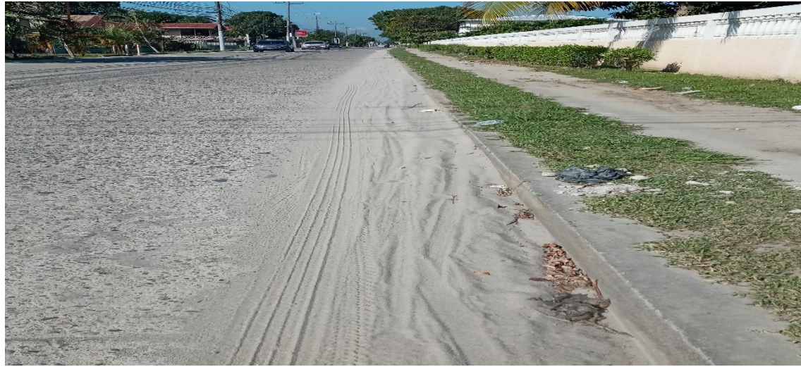
Calzada de calles azolvadas de arena barrio las Brisas y Barrio Independencia
