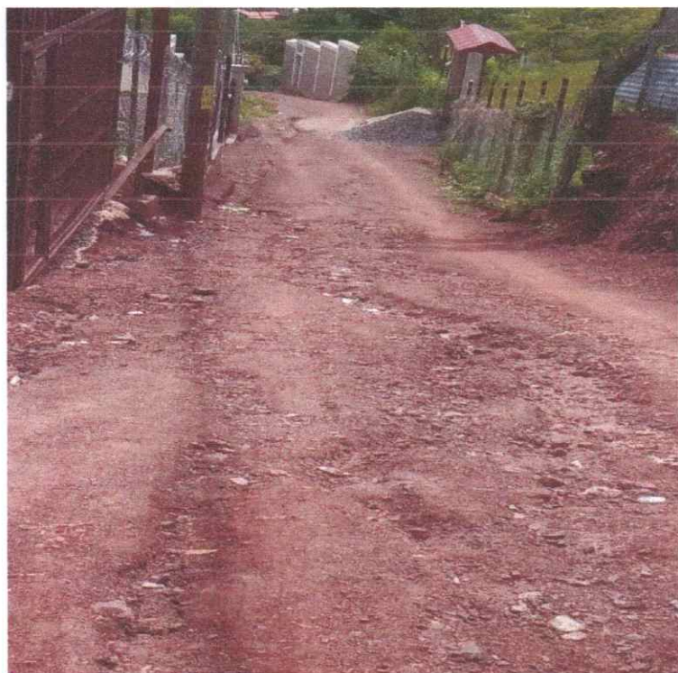
Fundición de calle Piedra grande aldea el chimbo
