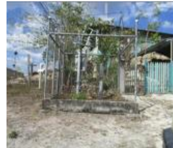
Imagen No 6. Estación Meteorológica Telemétrica - Regional de Comayagua
