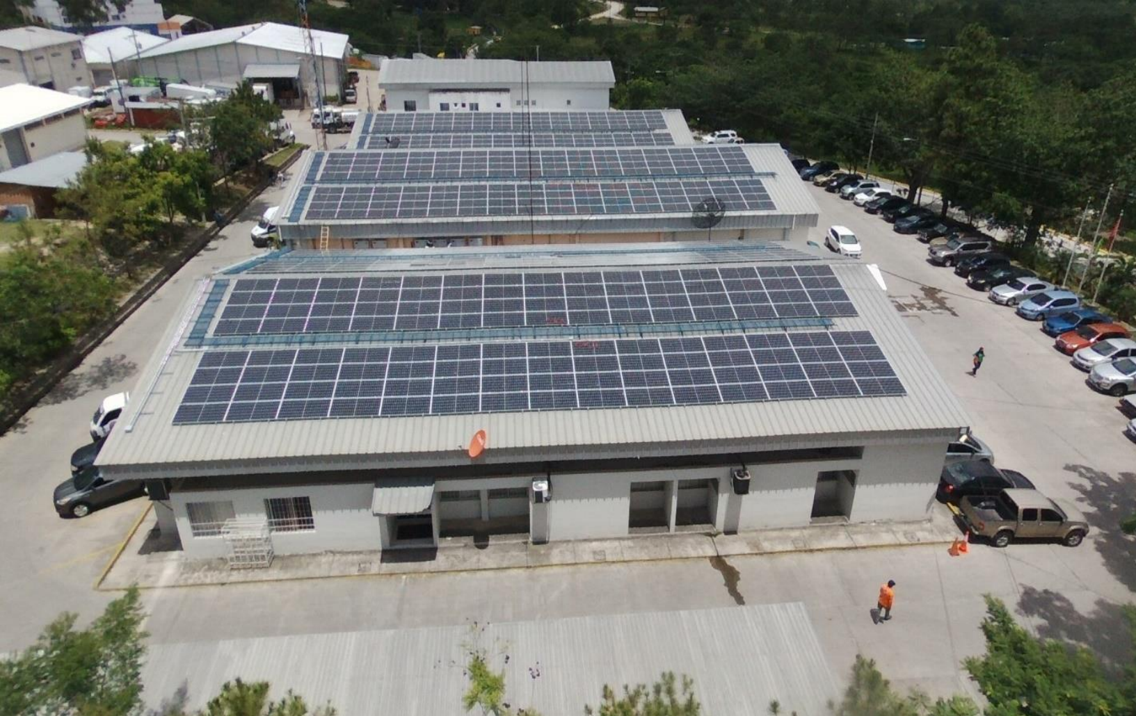
Perspectiva General. Planta Solar Fotovoltaica COPECO/Central
