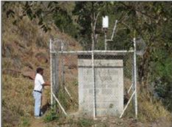
Estación telemétrica hidropluviométrica en San Francisco de Ojuera - Mi Ambiente
