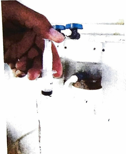
Mantenimiento de sistema de Dosificador de cloro
