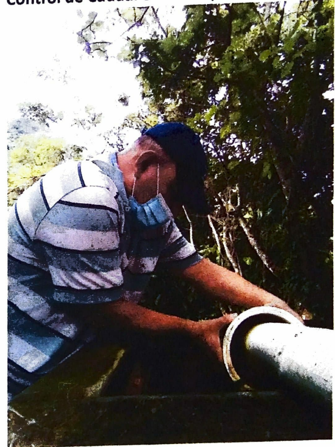
Control de Caudal en el tanque de entrada
