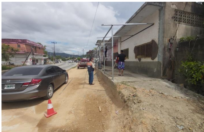
Identificación de construcción sin permiso en vía pública, Bo. La Laguna.
