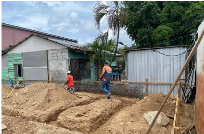
Colocación de orden de paro a construcción sin permiso, Bo. Copen.
