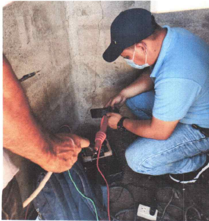
19. Electromecánica instalación de motor y bomba de 30HP/ 230V/ 3PH del Pozo Llanos de Canadá 2.
