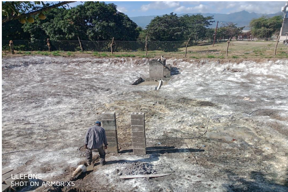
PECERA PREPARADA Y PENDIENTE DE SIEMBRA, CON CAPACIDAD DE (8000) ALEVINES
