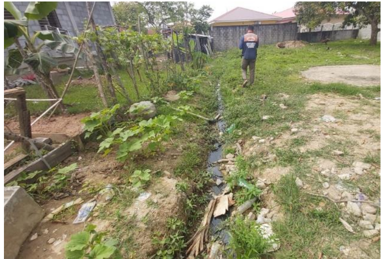
Atención de denuncia obstrucción de canal en El Zapotal, Cienaguita.
