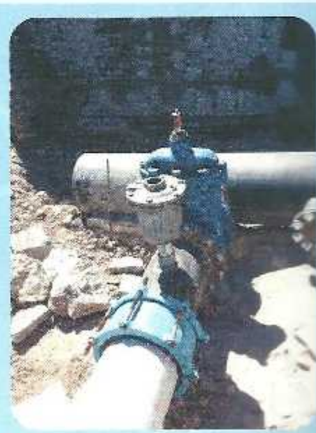
Válvulas de salida de la cisterna
