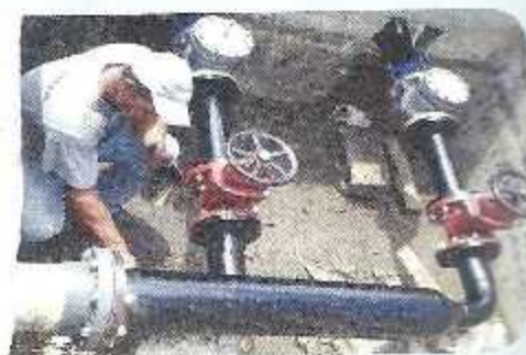
Equipo de bombeo instalado
