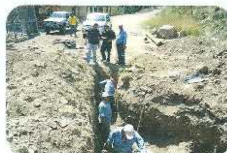
Línea de conducción Picacho-Cerro Grande
