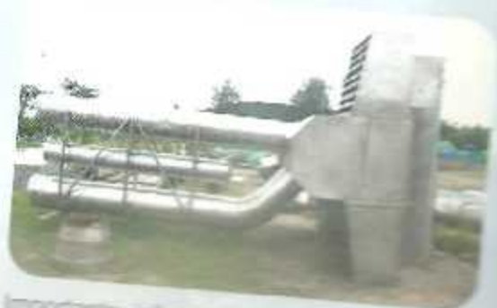
Importante infraestructura que ayuda a mejorar la calidad del agua que se extrae en el embalse Los Laureles.
